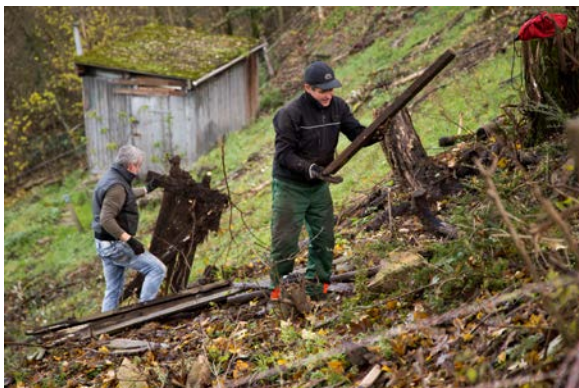
Aufräumarbeiten im Eichbachtal. (Foto: Roland Robra)
