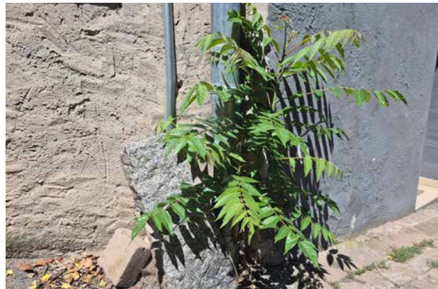
Ansiedlung am Mauerfuß – Schäden sind vorprogrammiert
